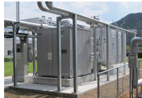
市島工場の廃熱回収設備
