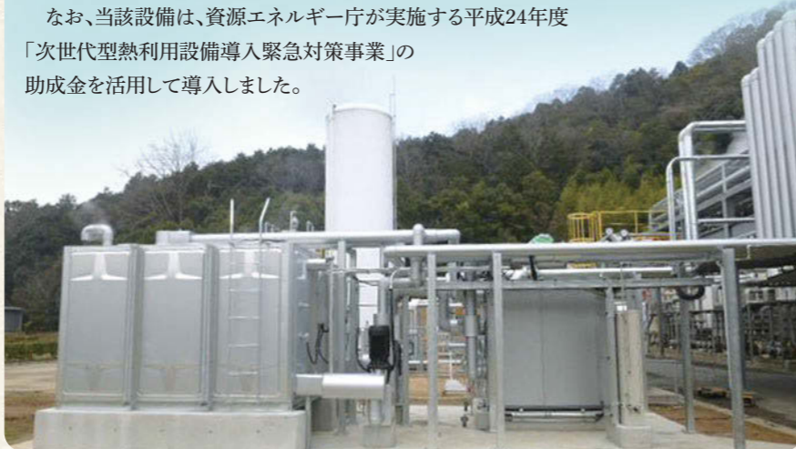
温水焚吸収式冷凍機と温水貯留タンク
